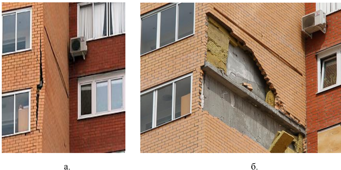
Рисунок 3 – Отслоение наружной облицовки многослойной стены: а - начало процесса; б - продолжение процесса
